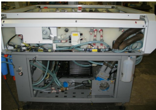
Bild 3, Seitenansicht rechts, mit neuem Kühlaggregat, Verschlauchung und Fittings
