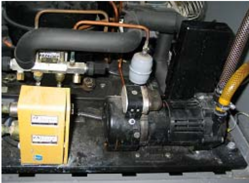
Bild 11, Original Kühlaggregat, Entwickler zirkuliert durch das Gerät
