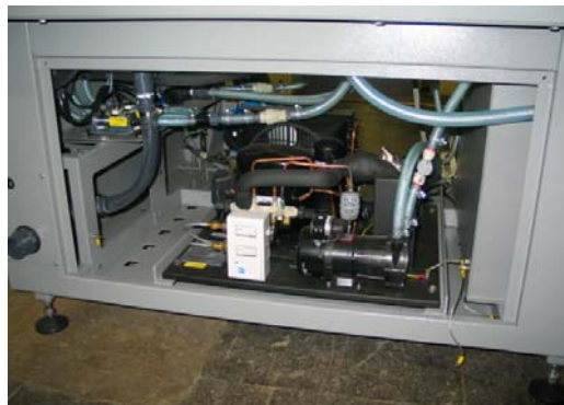
Bild 14, Kühlaggregat im eingebauten Zustand
